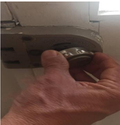
Foto 8. Chapa de puerta de ingreso dañada
