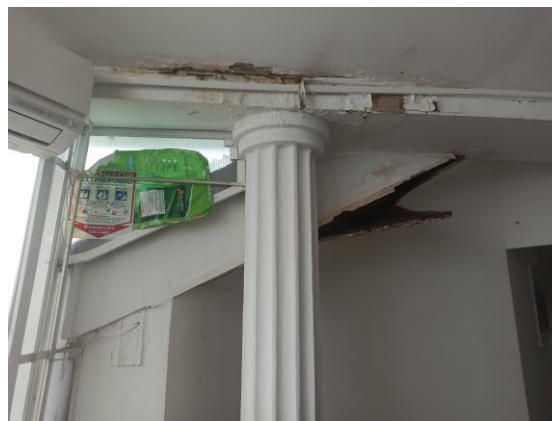
Foto 3. Humedad al interior
