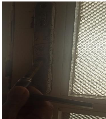
Foto 9. Manija de puerta de ingreso dañada
