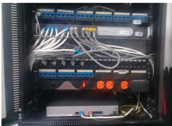
Imagen 5. Rack de comunicaciones de la sede regional.
