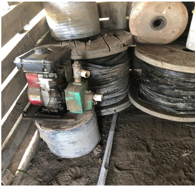
Material de bombeo y distribución
