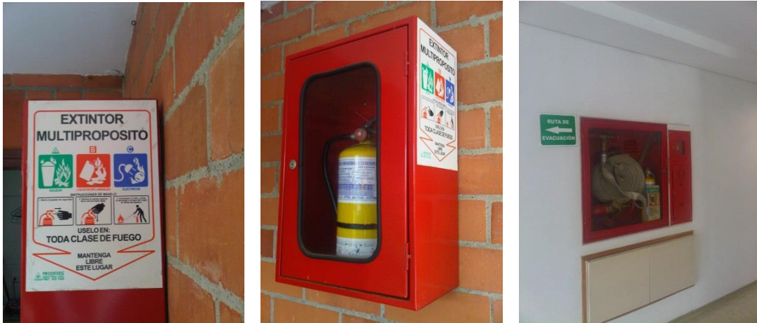
Figura -5 Sistema manual contra incendios
