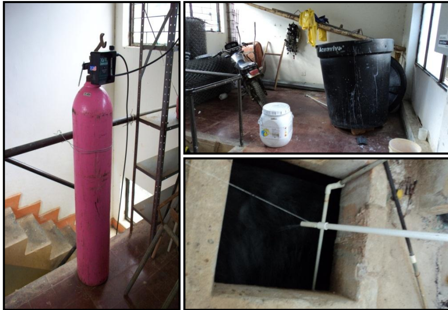
Figura 29. Sistema de Dosificación de Cloro Gaseoso y Granulado
