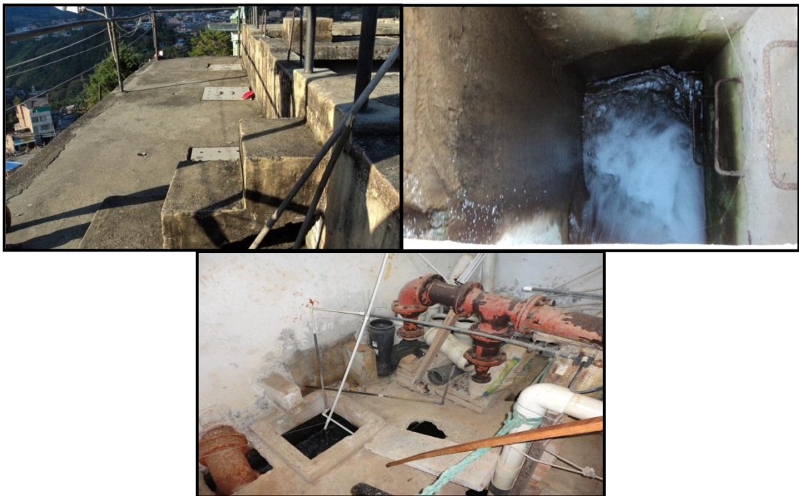
Figura 32. Galería de Agua Filtrada
