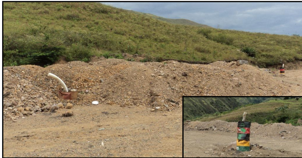
Figura 41. Drenaje de Gases - Chimeneas
