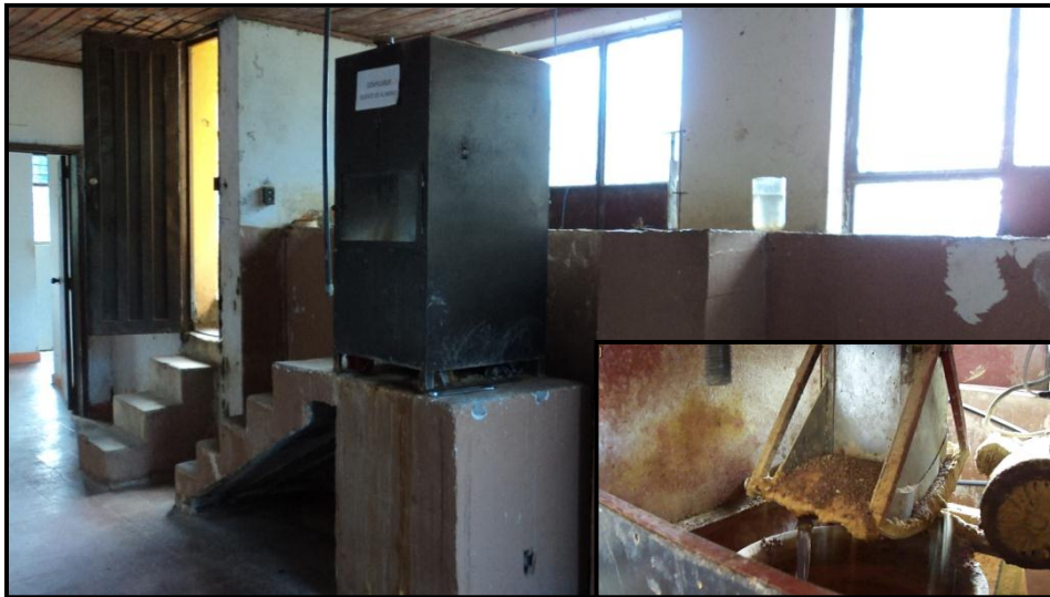
Figura 27. Equipo Dosificador de Sulfato de Aluminio Sólido - Tipo B
