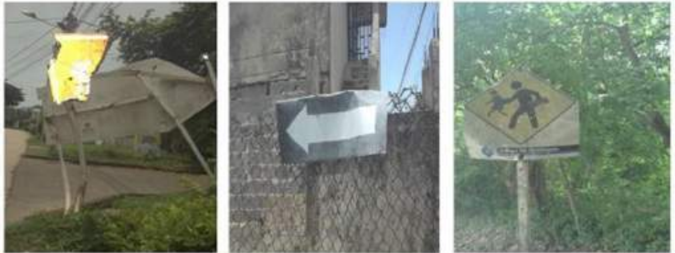
Imagen 66 - Señales de tránsito en mal estado
