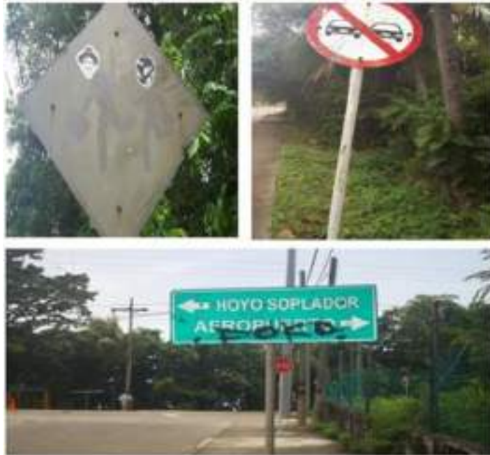
Imagen 63 - Señales de tránsito en mal estado
