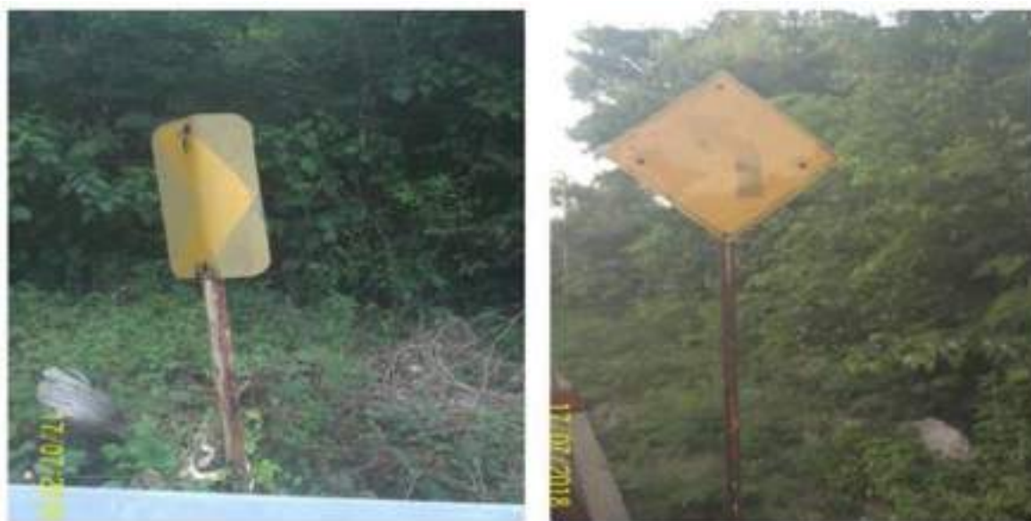
Imagen 72 - Señalización en mal estado, Providencia
