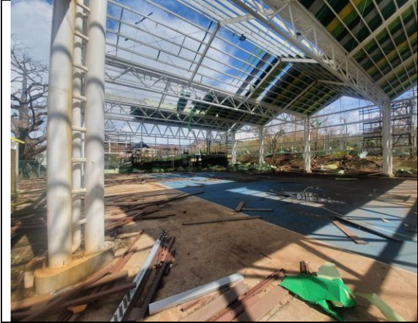
Fotografía 15. Afectación en cubierta y puesta a tierra.
