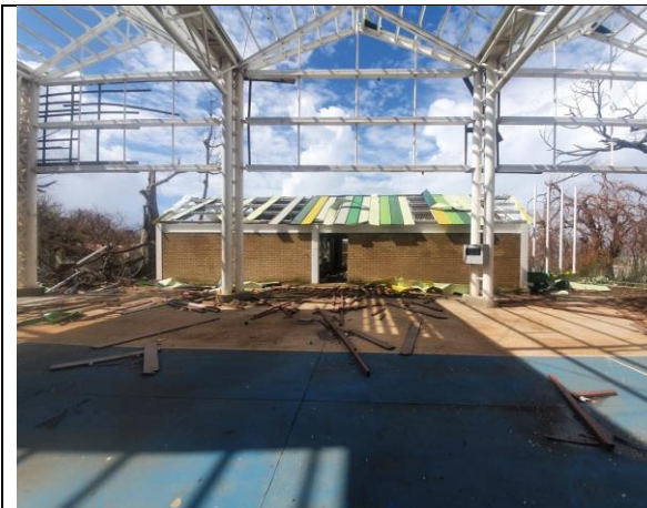
Fotografía 13. Afectación en la Cubierta.
