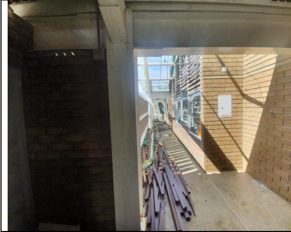
Fotografía 11. Cielos rasos destruidos.
