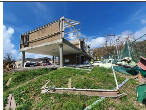
Fotografía 18. Cerramiento lateral totalmente destruido.
