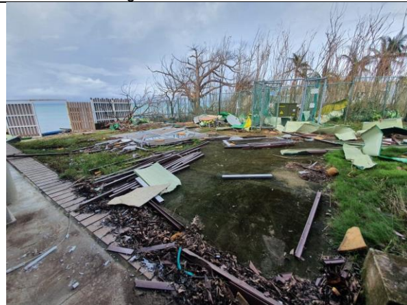
Fotografía 4. Daño total en la carpintería metálica y estructura liviana del Colegio.
