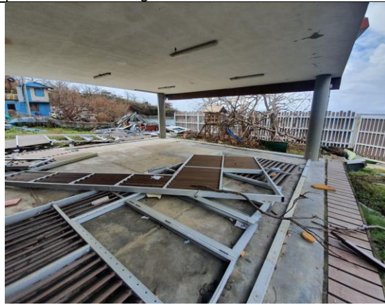
Fotografía 3. Daño total en la carpintería metálica y estructura liviana del Colegio.
