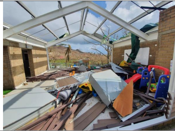
Fotografía 20. Cielo raso, cubierta y elementos de iluminación destruidos.
