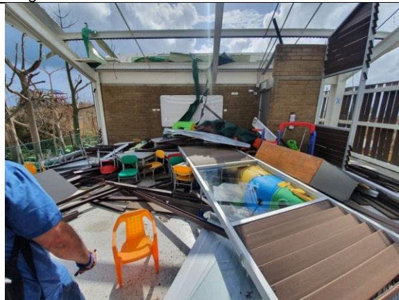
Fotografía 21. Estructura liviana y mobiliario llevado por la UNGRD destruido.
