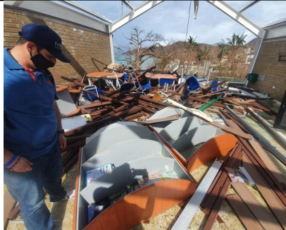
Fotografía 9. Estructura liviana y cubierta destruidas.
