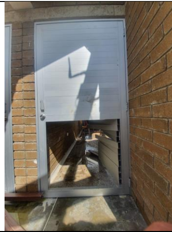
Fotografía 12. Puertas en aluminio Afectadas, o vandalizadas al tomarse el colegio como refugio por parte de la población.
