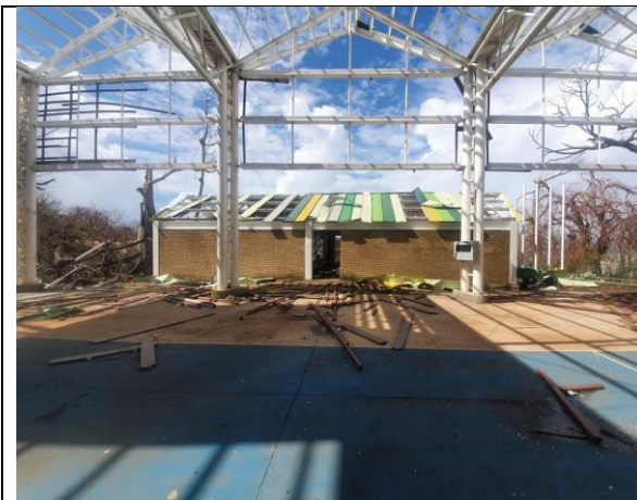
Fotografía 13. Afectación en la Cubierta.
