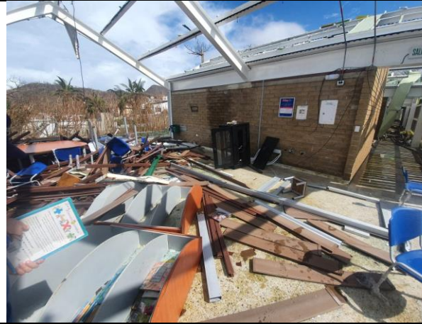
Fotografía 8. Estructura liviana y cubierta destruidas.
