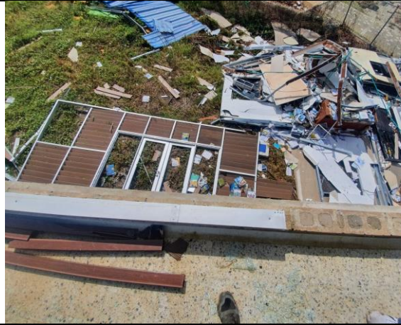
Fotografía 7. Estructura liviana destruida.
