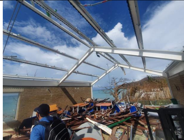
Fotografía 10. Cielo raso, cubierta y elementos de iluminación destruidos.
