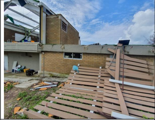
Fotografía 25. Caída total de cerramientos en estructura metálica y madera plástica.
