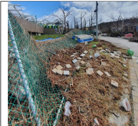
Fotografía 1. Daño total en el cerramiento perimetral del colegio.
