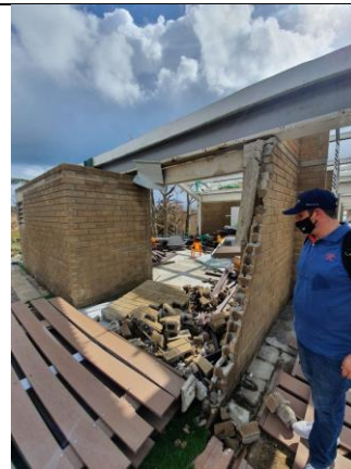
Fotografía 22. Muro de salida a zona de recreación en preescolar afectado producto de la caída del cerramiento, donde se confinaba dicho muro.
