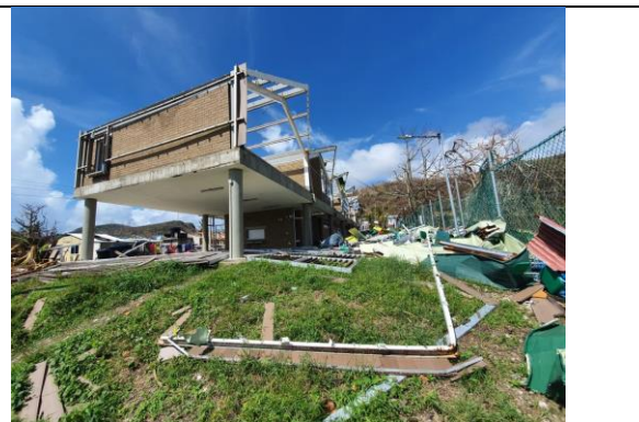
Fotografía 18. Cerramiento lateral totalmente destruido.
