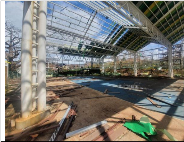
Fotografía 15. Afectación en cubierta y puesta a tierra.
