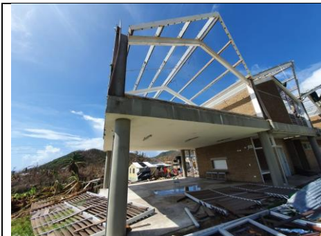
Fotografía 17. Afectación en la cubierta, estructura liviana de cerramiento.
