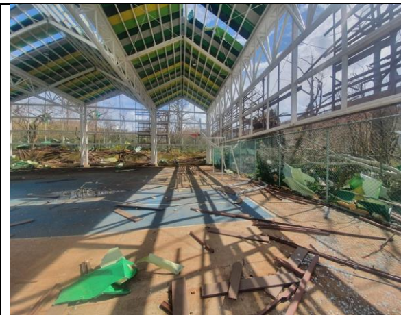
Fotografía 14. Afectación en cubierta y en tableros de básquetbol.
