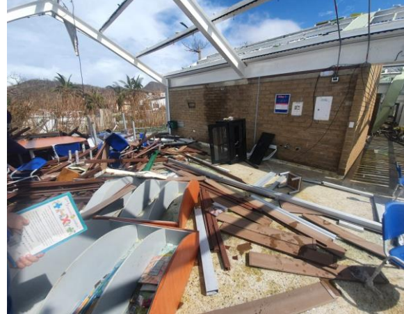
Fotografía 6. Cubierta Colegio en el piso producto de los fuertes vientos.
