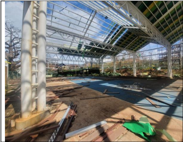
Fotografía 15. Afectación en cubierta y puesta a tierra.
