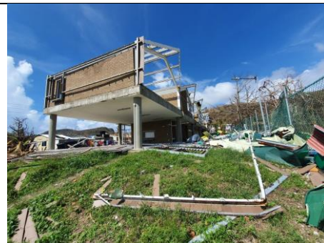
Fotografía 18. Cerramiento lateral totalmente destruido.
