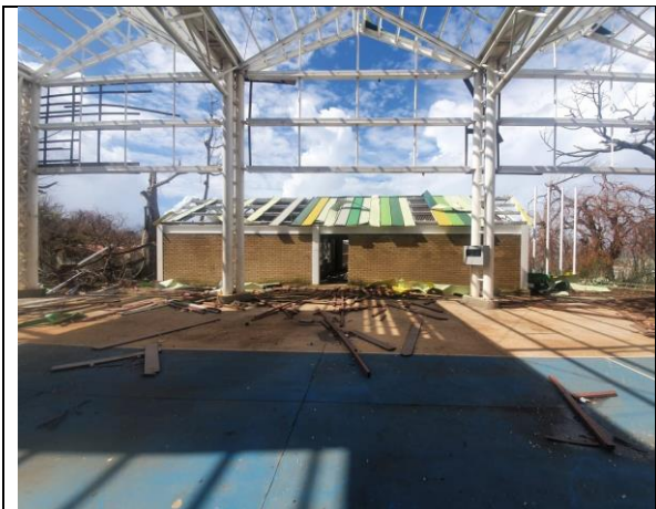
Fotografía 13. Afectación en la Cubierta.
