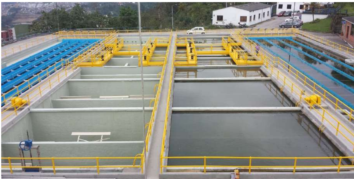
Manizales, Caldas OPTIMIZACIÓN PLANTA NIZA Y CONSTRUCCIÓN LÍNEAS DEL BY PASS EN EL SECTOR DE LA PTAP LUIS PRIETO GÓMEZ Valor: $11.287 millones Población Beneficiada: 376.868 habitantes
