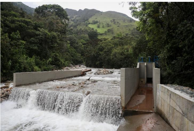
Acueducto – Conducción y planta agua potable Socorro, Santander
