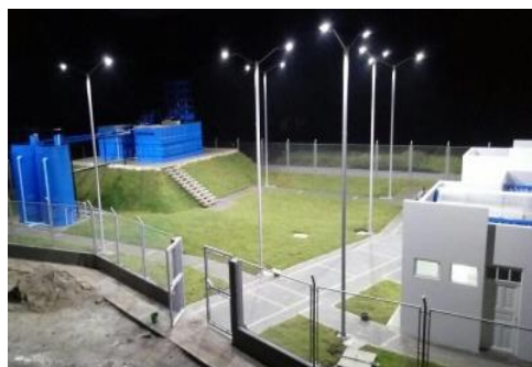
ACUEDUCTO - PLANTA AGUA POTABLE GUALMATÁN, NARIÑO
